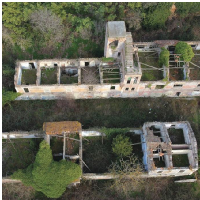
Vista dall'alto dei due edifici: i tetti sono crollati e la vegetazione ha invaso gli interni.
